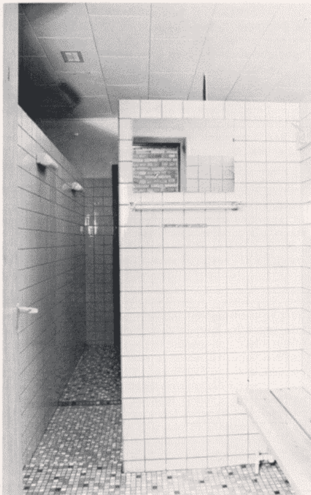
36 Sluserum til stalde med flisebeklædte vægge.
