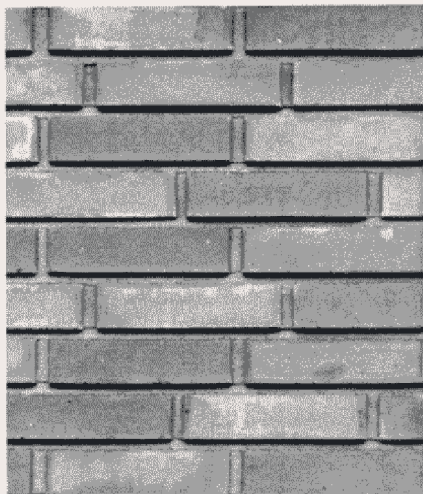
Misfarvet murværk ser ikke godt ud.
